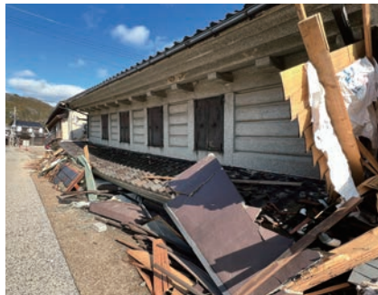
1階部分が潰れた家屋
