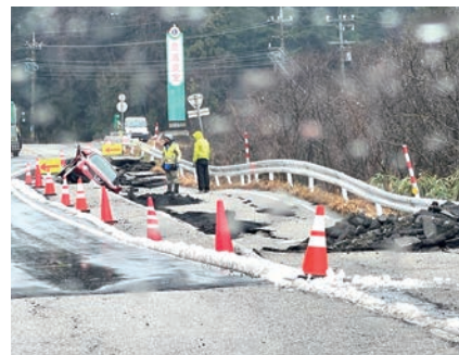
陥没した穴に落ちた車
